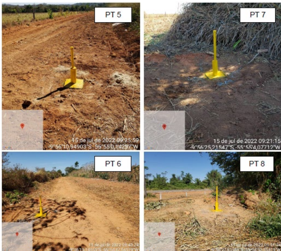
Figura 26. Poços de monitoramento de águas subterrâneas conforme ABNT NBR 15495-1:2007, instalados durante o estudo de passivo ambiental.
